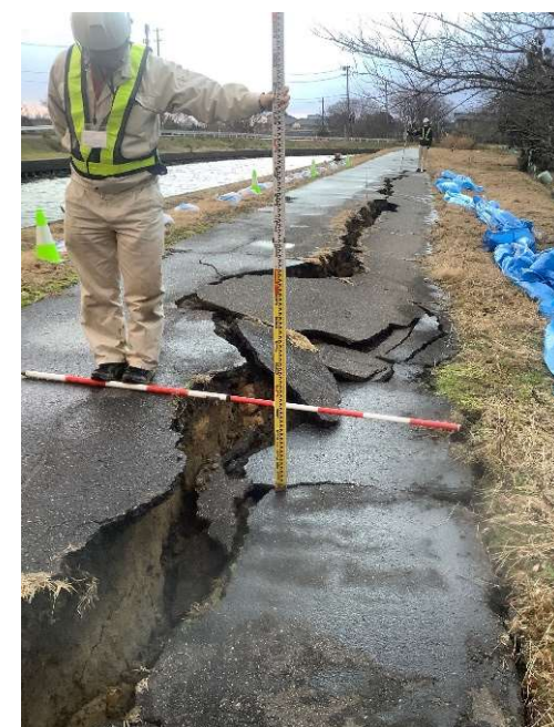
堤防被災調査の様子 (株)クリエイトセンター 提供
