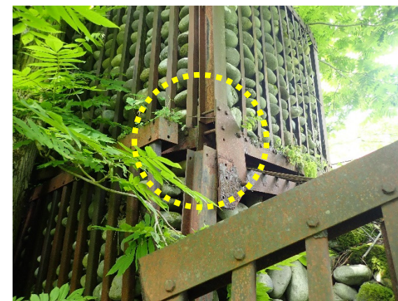
【連結ボルトの破損】
