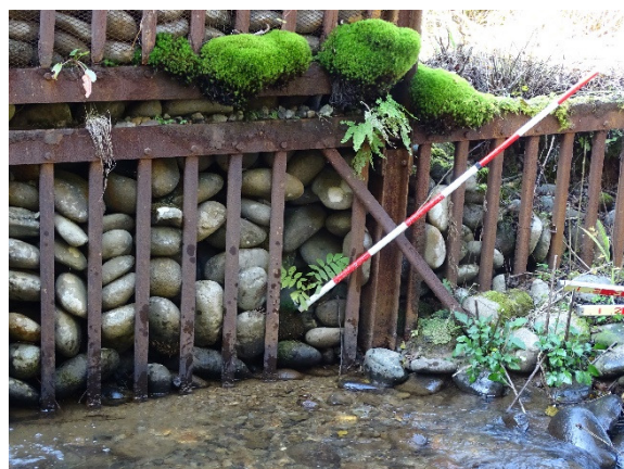
【変状レベルc－部材の破損】
