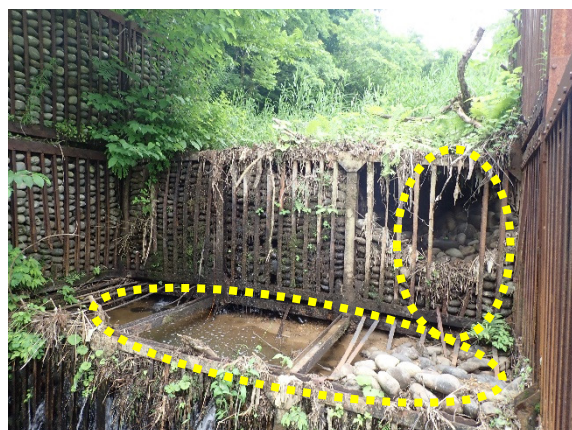
【上下流面・蓋スクリーンの破損】
