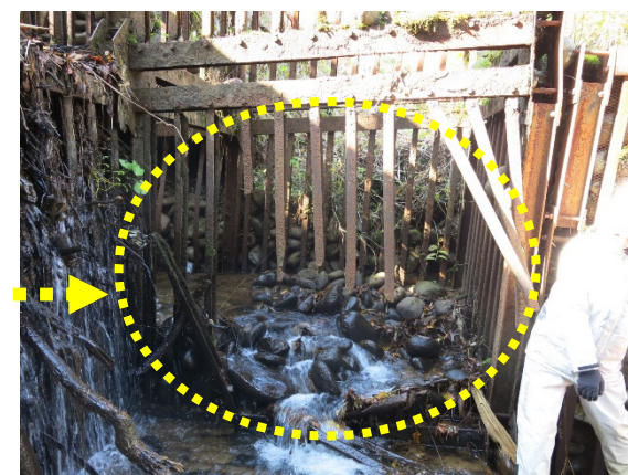
【側面スクリーンの破損(拡大)】
