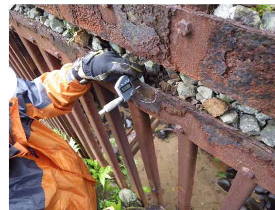
【変状レベルb－かさぶた状の錆】
