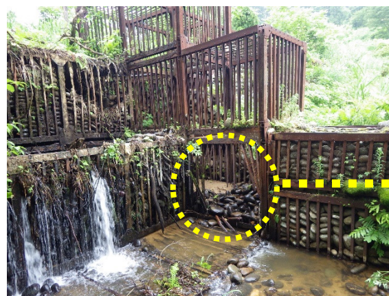
【側面スクリーンの破損】
