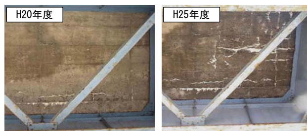
写真-1 H20とH25の損傷状況比較
