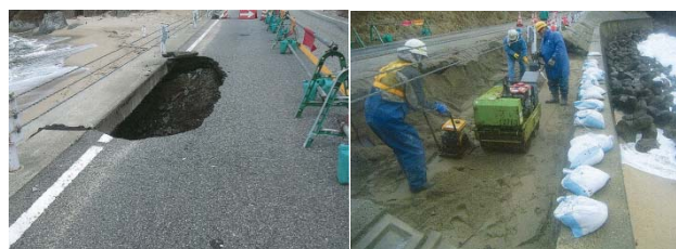
写真1 道路陥没(左)と補修状況(右)
