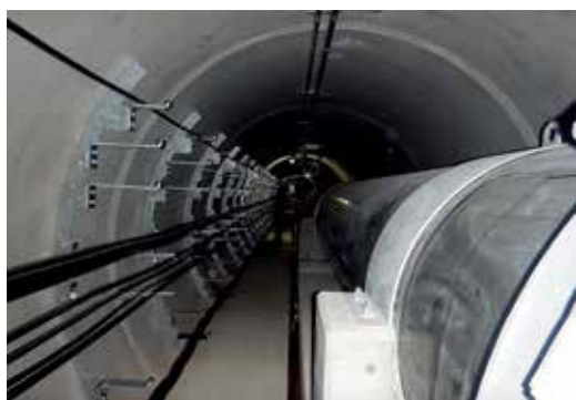
共同横断管内部
