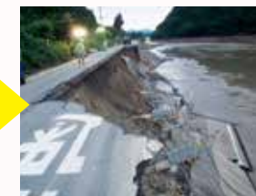
7月31日/下り線側車線陥没
