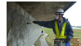
高所作業車での橋梁点検。構造物に接近して目視し、点検ハンマーで打音検査を行って、異常の有無を確認
