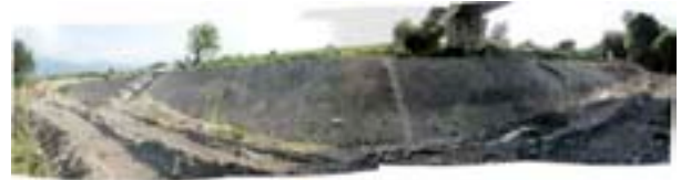
低水護岸欠壊状況 (全景)
