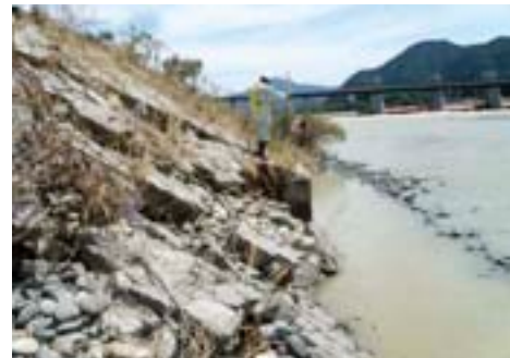
低水護岸欠壊状況
