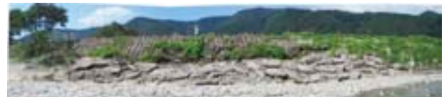
低水護岸欠壊状況 (全景)
