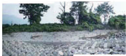
床固護床工流出状況 (全景)
