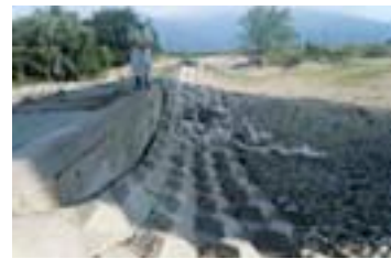
低水護岸欠壊状況
