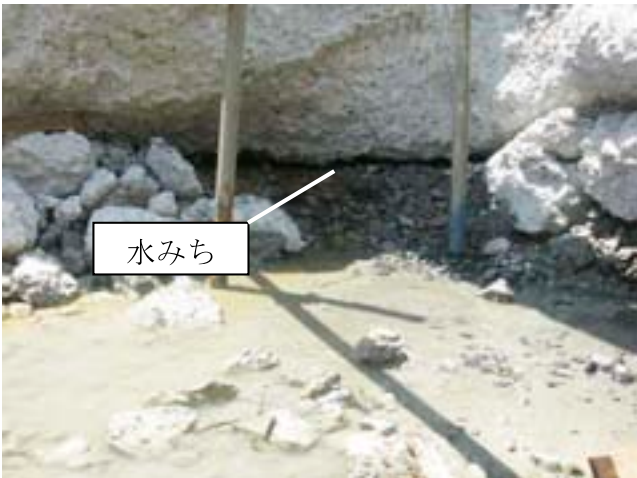
写真-3 底版底面の隅間（水みち）の様子
