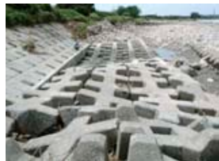
護床工流出状況
