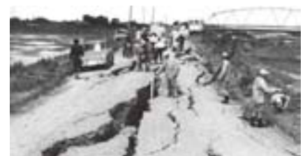
(阿賀野川 堤防亀裂)
