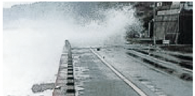
一般国道160号における越波
