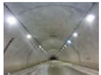
トンネル内照明 （LED）の点灯状況
