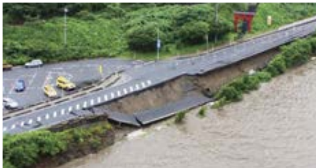
図-12 崩落発生（H25. 7.18）
