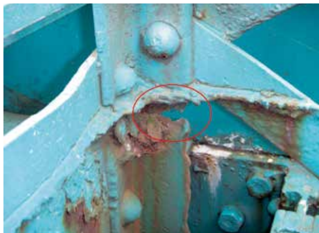
格点内部の腐食
