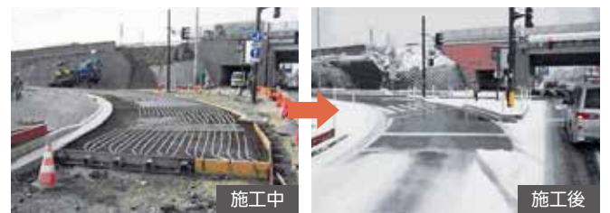
インターチェンジ交差点部のヒートパイプ整備事例 写真提供:(株)興和
