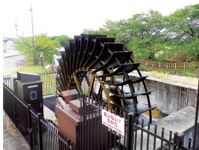
常西公園小水力発電所
