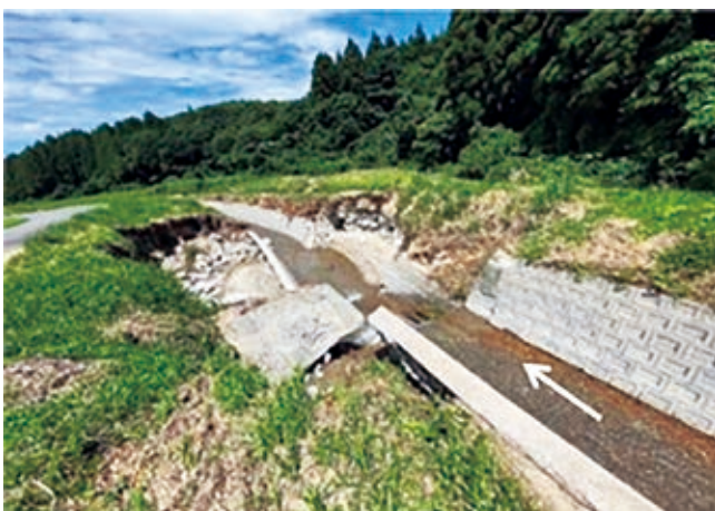
写真-2 護岸被災状況 (村上市春木山地区)
